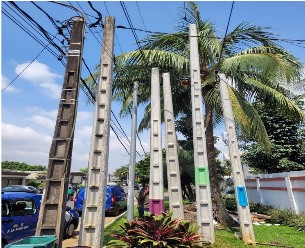
Figure 1 : Photo d'implantation des poteaux des opérateurs dans une rue d'Abidjan
